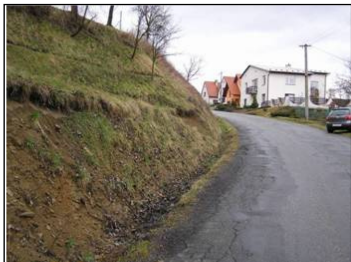
nevyhovující levá krajnice – odvodnění, vysvahovaný terén km 2.760 – 2.820
