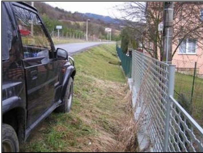
Budoucí chodník v násypu – nutná opěrná zídka nejlépe na hranici pozemku – od km 2.920
